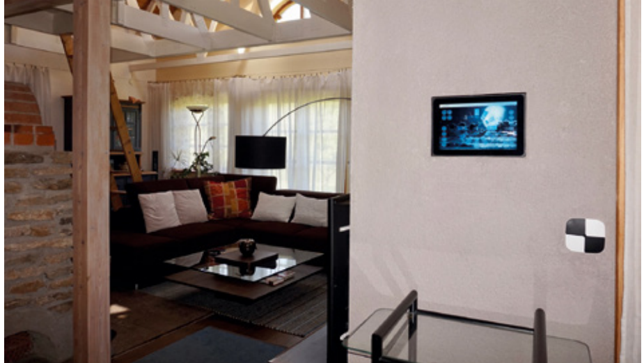
An der Wand im Wohnzimmer wurde das Touch-Panel „Sallegra Multitouch“ und das „KNX Homepad“ (Lichtschalter) montiert.
